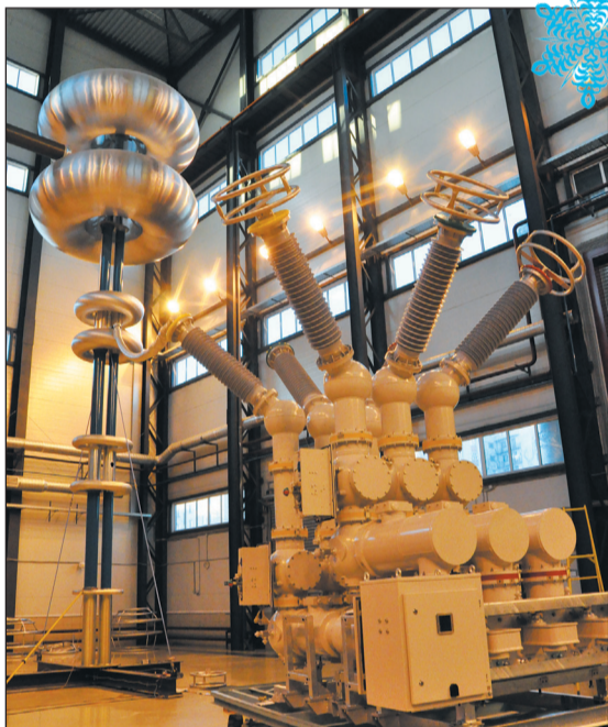
Комплектное распределительное устройство с элегазовой изоляцией КРУЭ-110 кВ
